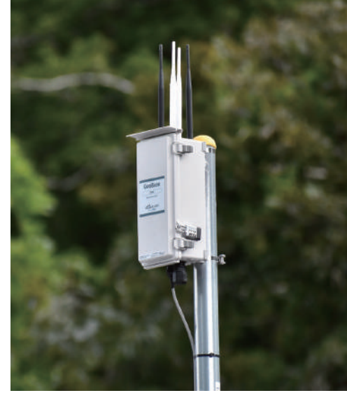
■事務所屋上に設置された親機「GeoBase」
