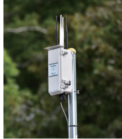
■事務所屋上に設置された親機「GeoBase」
